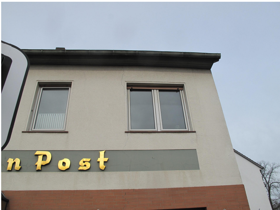
Bild 20: Riss in der straßenseitigen Fassade Bauteil 1
