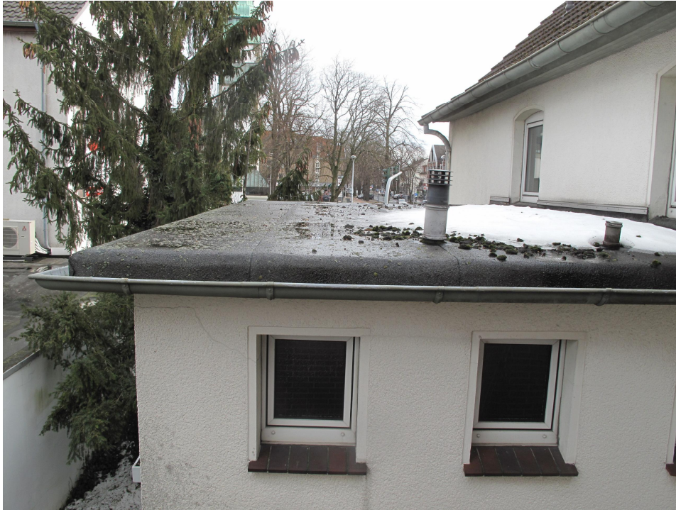
Bild 22: Risse oberer Teil Anbau an Bauteil 1
