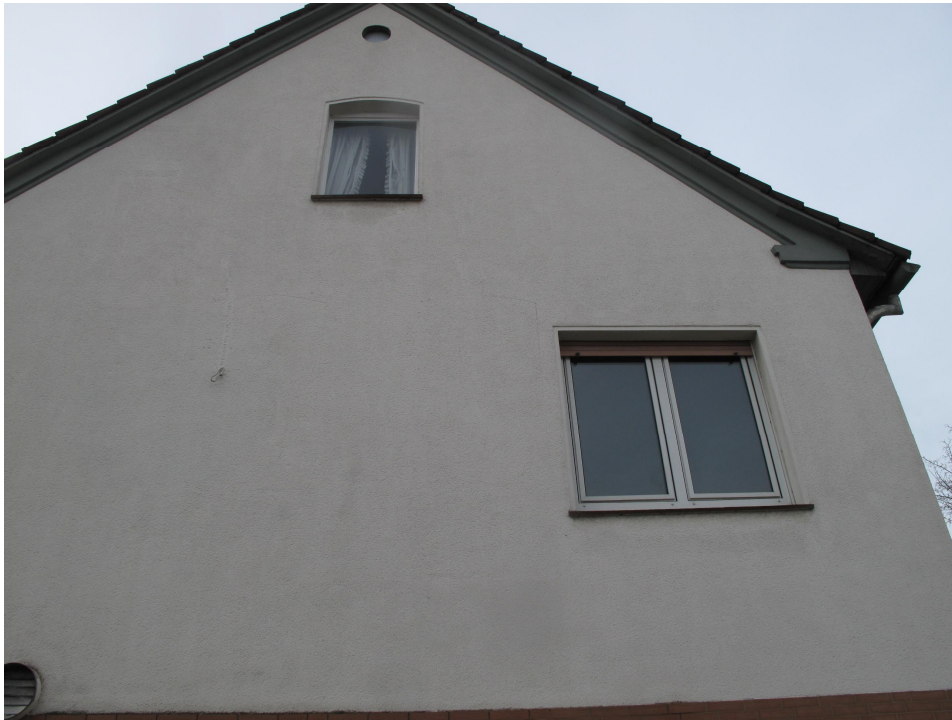
Bild 21: Risse in giebelseitiger Fassade Bauteil 1
