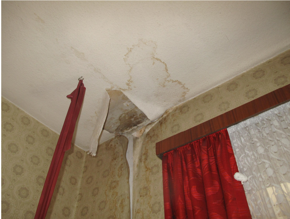
Bild 10: Feuchtigkeitspuren an Decke
