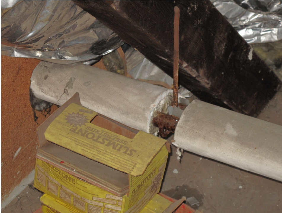
Bild 6: Gedämmte Wasserrohre im DG
