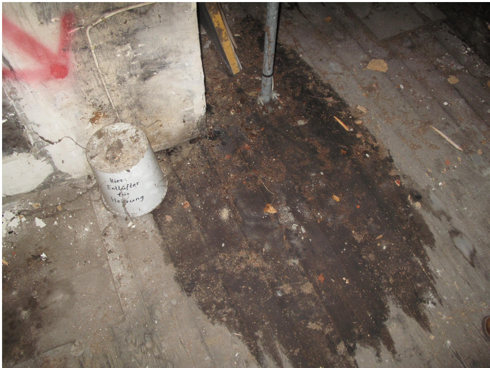
Bild 2: Feuchtigkeit am Boden DG (frisch)
