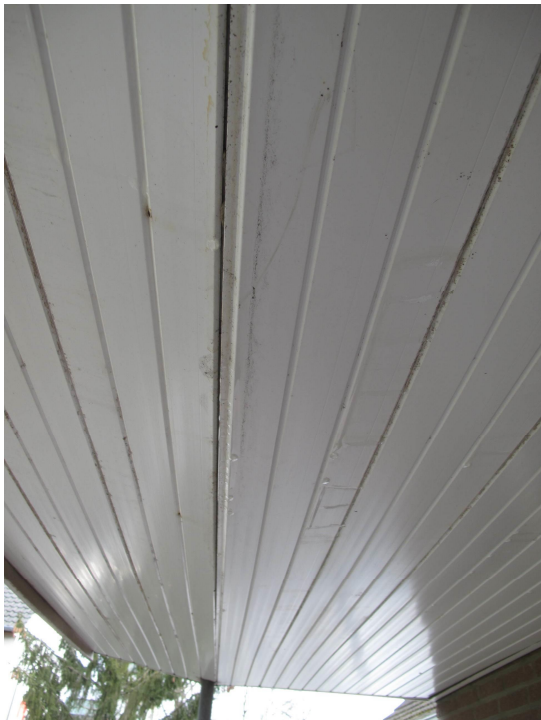
Bild 15: Wasserspuren an Verschalung Balkon
