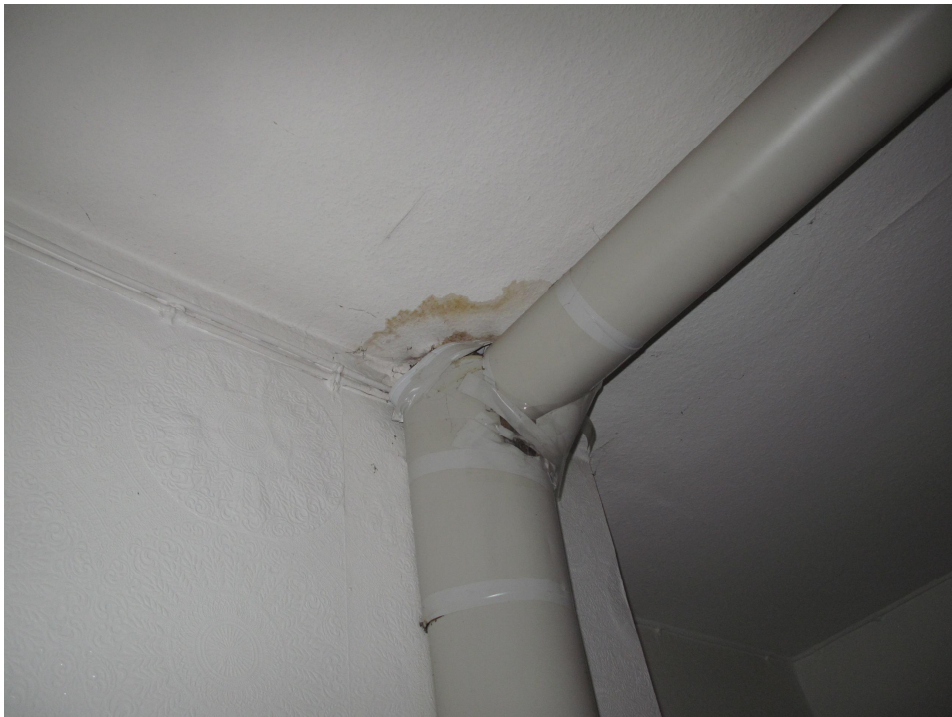
Bild 9: Feuchtigkeitsspuren an Decke im Bereich von Wasserrohren
