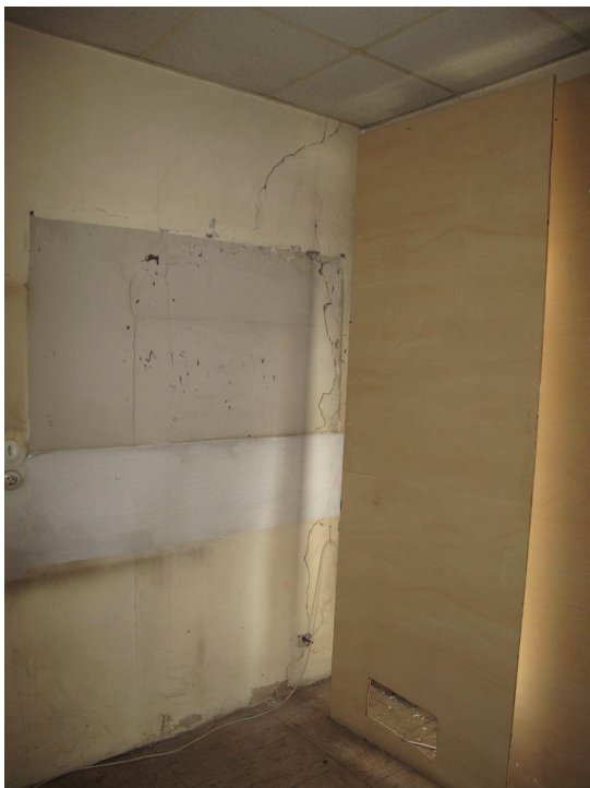
Bild 16: Riss in Innenwand Bauteil 2
