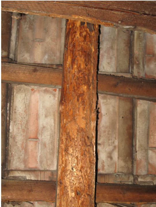
Bild 4: Sparren mit Beschädigungen durch Schädlingsbefall
