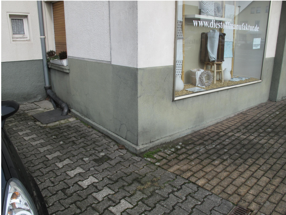
Bild 19: Putzrisse an Fassade Bauteil 2
