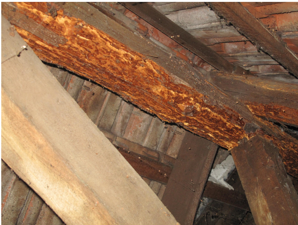
Bild 5: Firstpfette mit Beschädigungen durch Schädlingsbefall
