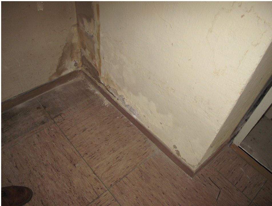
Bild 17: Putz- und Farbabplatzungen an Wänden Bauteil 2
