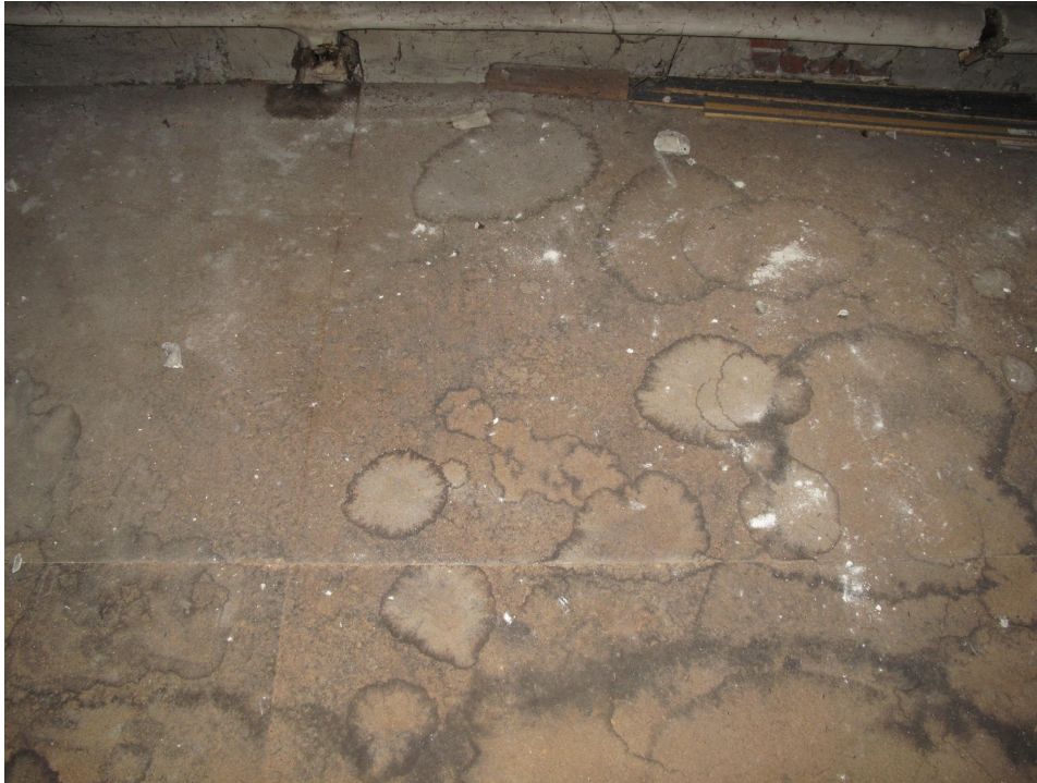
Bild 3: Ältere Feuchtigkeitsspuren am Boden DG
