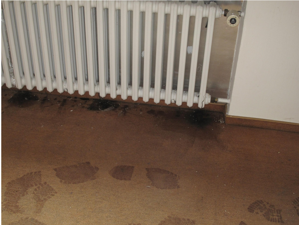
Bild 11: geplatzter Heizkörper im 1. OG
