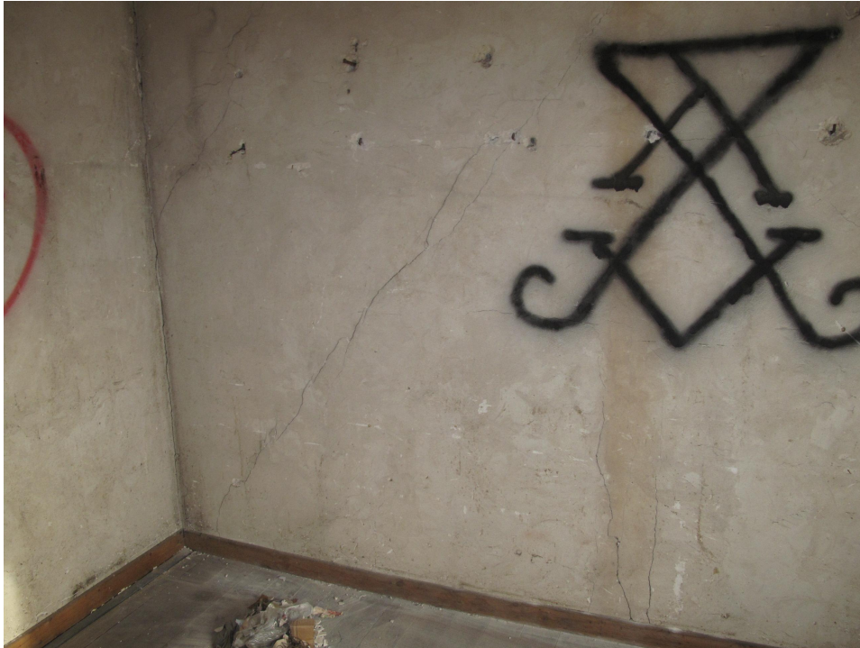
Bild 7: MW-Wand im DG mit Rissen
