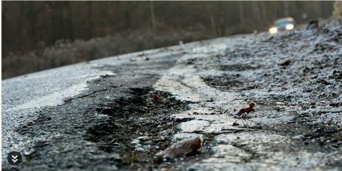
Unübersehbar: Schäden an Wirtschaftswegen Foto: dpa
